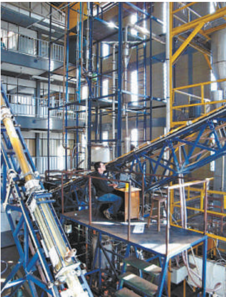
Tubulações internas do laboratório, que terá capacidade de simular escoamentos de óleo e gás que se assemelhem às condições do pré-sal
